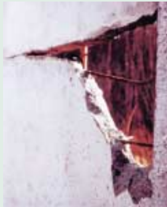
Loch in der Mauer
